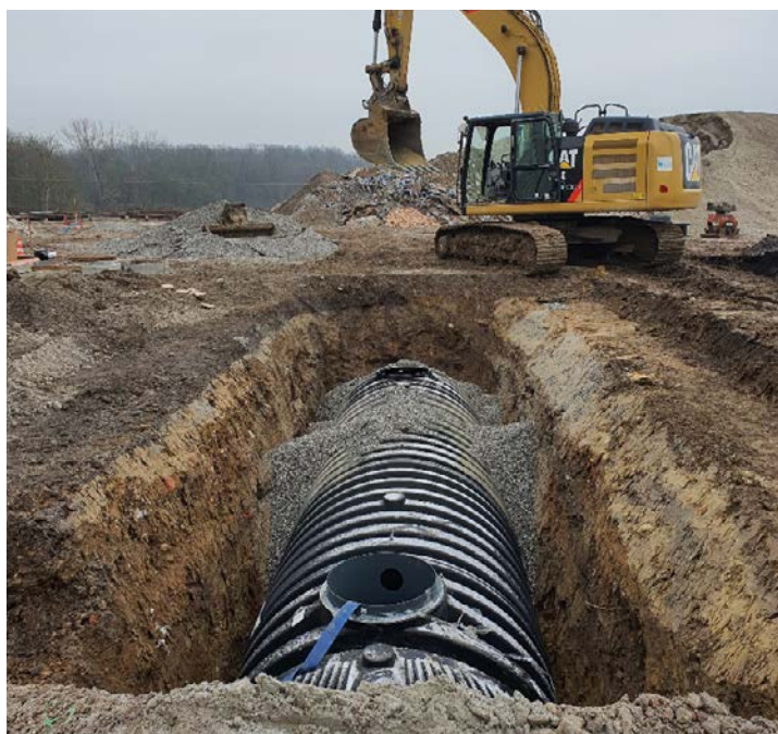
La citerne de récupération de 42 000 litres posée sur le site de recyclage servira à l'arrosage des pistes de manoeuvre et au lavage des engins et camions. Elle est alimentée en eau de pluie par une toiture de 650 m 2 .
